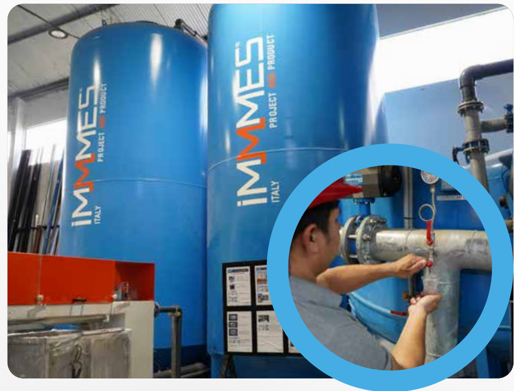
Nuestra Planta de Tratamiento de Agua - IMMES
